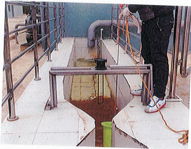
总排口 1#废水检测点位
