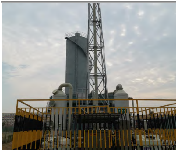
API 高浓度污水处理站恶臭处理系统
