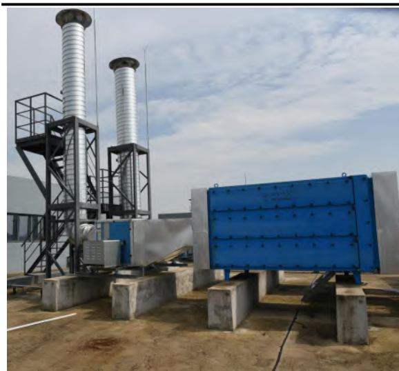
1#固相合成活性炭吸附装置及排气筒
