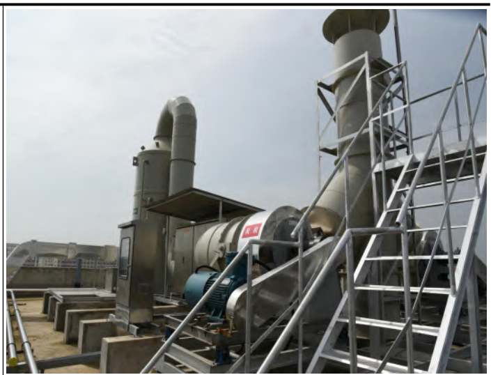
1#裂解水喷淋+UV 光解废气处理及排气筒
