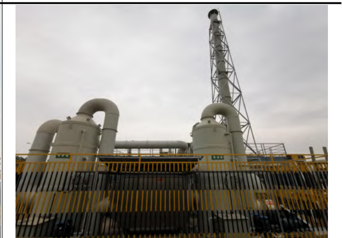
OSD 低浓度污水处理站恶臭处理系统
