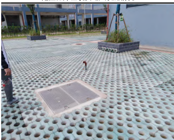
危险废物暂存间外配套的防泄漏池
