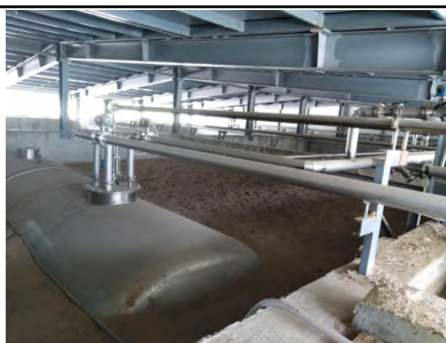
原料罐区（乙腈储罐）
