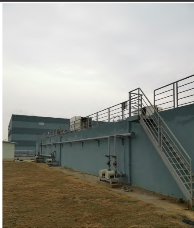
OSD 低浓度污水处理站
